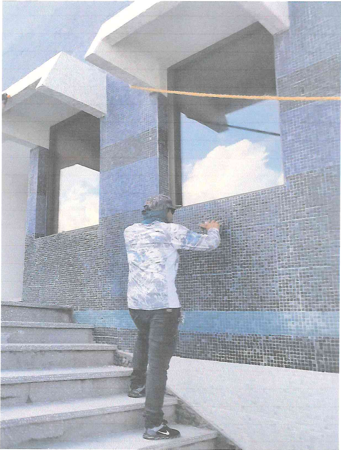
Limpeza y desinfección de teselas en segmento A5 de la fachada Oriente.
