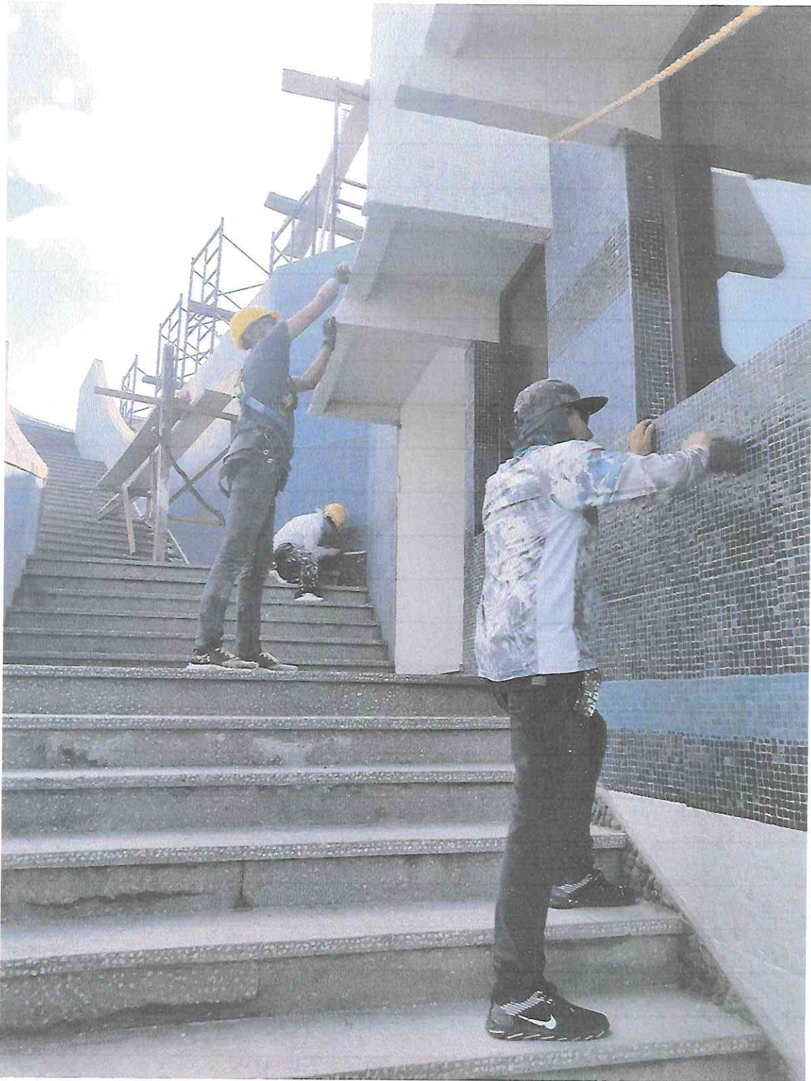
Limpieza y desinfección de teselas en segmento A5 de la fachada Oriente.
