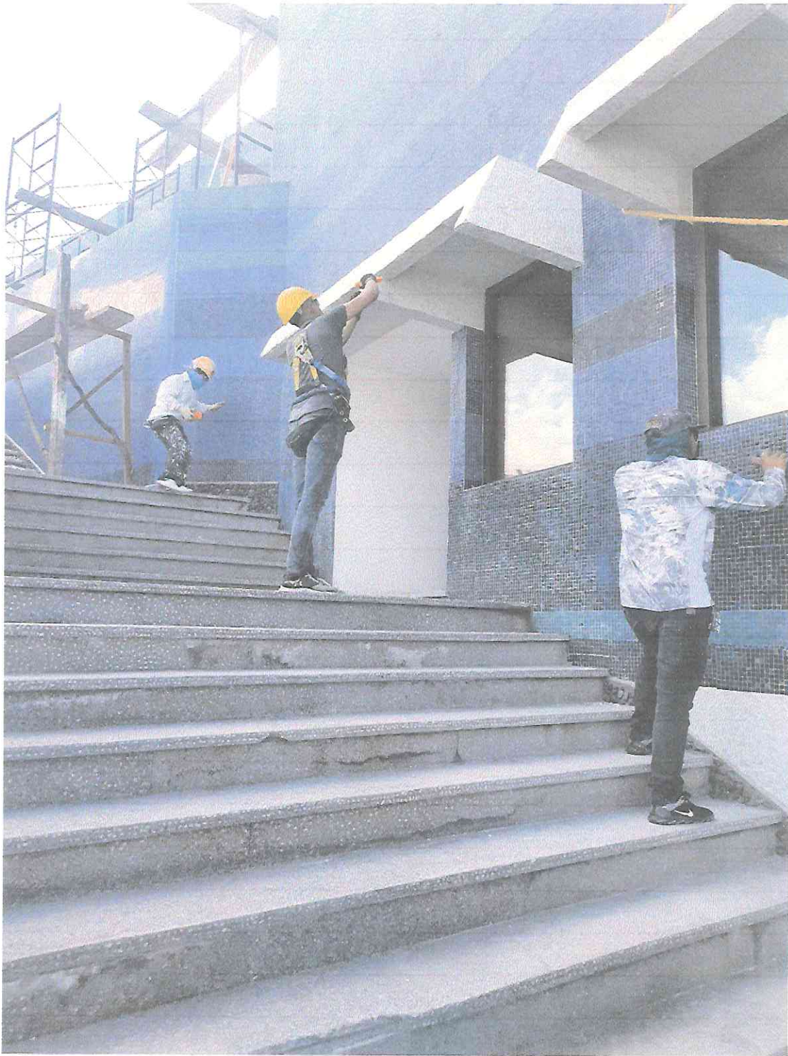
Limpeza y desinfección de teselas en segmento A5 de la fachada Oriente.
